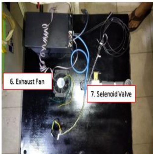
Gambar 2. Blok Kontrol Pada Bagian Atas
