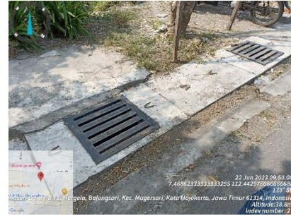
Gambar 4 Jaringan Drainase Tersier
