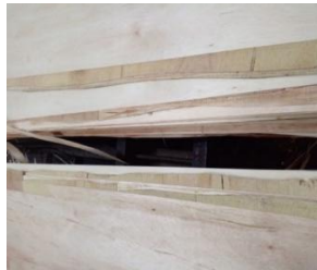
Gambar 4. Dokumentasi Defect Delaminasi Sumber : Data PT. SXX
